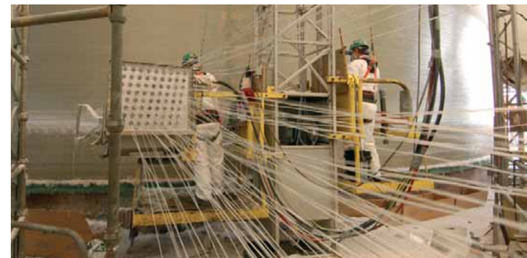
美国 Ershigs 已制造出直径为 88 英尺、高 75 英尺 (26.8 x 22.9 米) 的纤维缠绕 FRP 罐。
