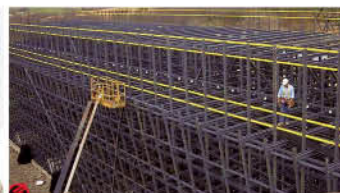
发电厂冷却塔
